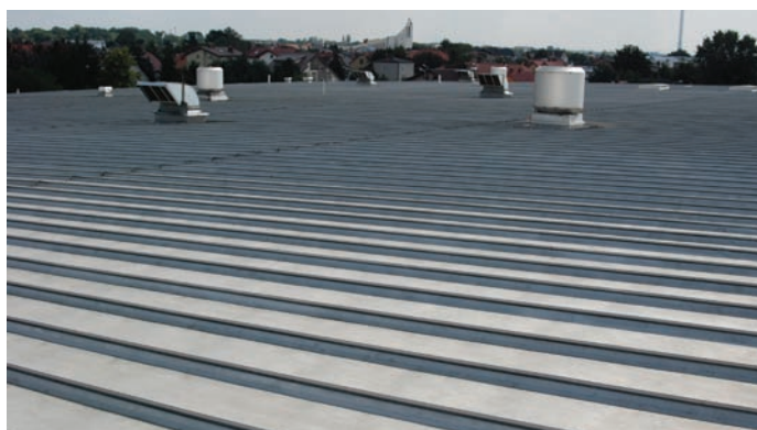
Siedemnastoletni dach Astrotec (poprzednik dachu LMR600)
